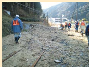
台風による被害の様子
