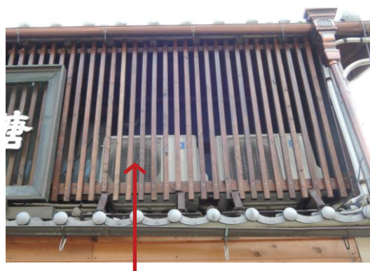
電気設備や室外機を木製格子で覆った例
