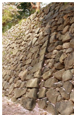
石垣の継ぎ足し部分
