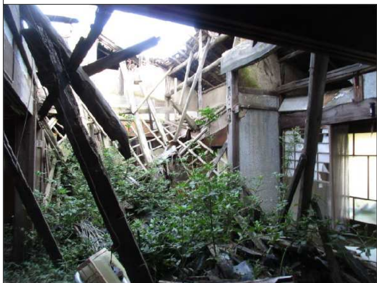
内観（崩落状況）
