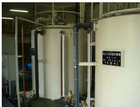
写真-4 塩素注入設備 (三雲浄水場)
