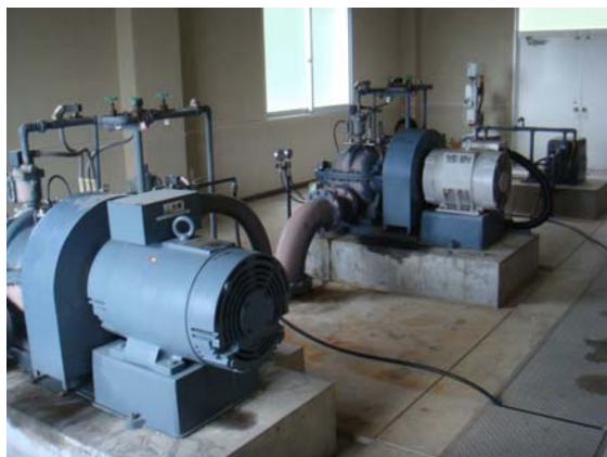
写真-6 ポンプ設備 (安濃浄水場)
