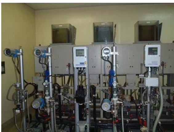
写真-3 水質監視機器 (三雲浄水場)
