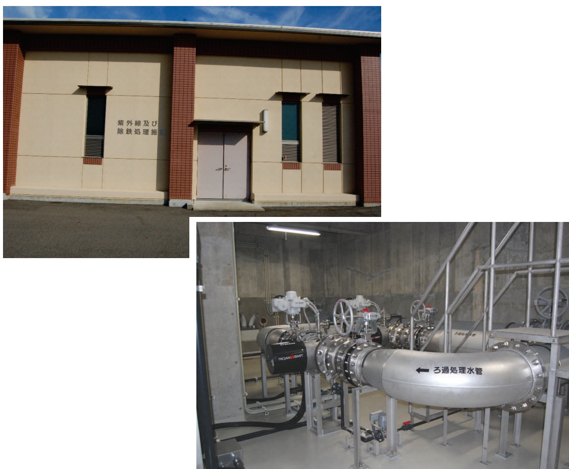
図 5.8 紫外線処理設備（高茶屋浄水場）
