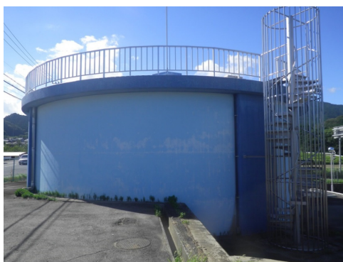
図 5.1 美里穴倉配水池
