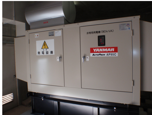
図 5.12 高野尾ポンプ場非常用発電設備
