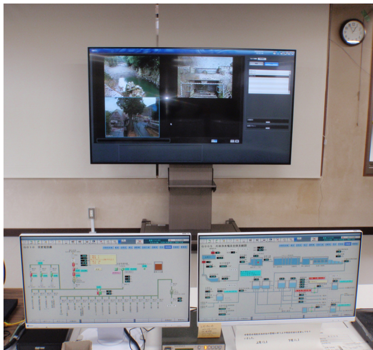
図 5.13 片田浄水場中央監視装置
