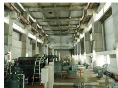
ポンプ棟内部
