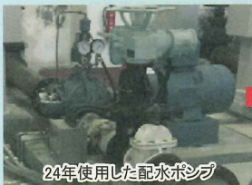
24年使用した配水ポンプ
