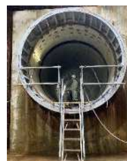
大きな雨水管 中に作業員がいます
