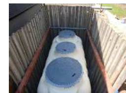
市が設置した浄化槽
