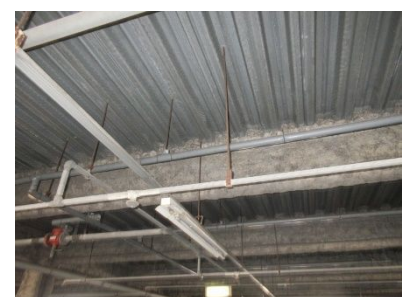
ポルタひさい駐車場 照明器具
