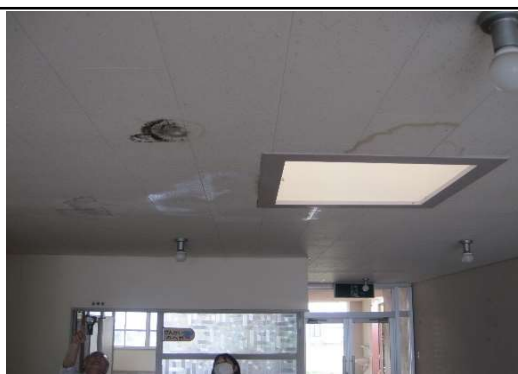
13 館内雨漏りの状況
