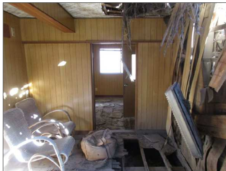
内観（崩落状況）
