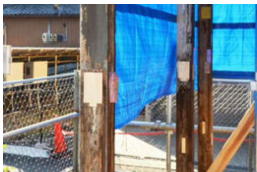
写真 4-17 窓敷居の痕跡詳細
