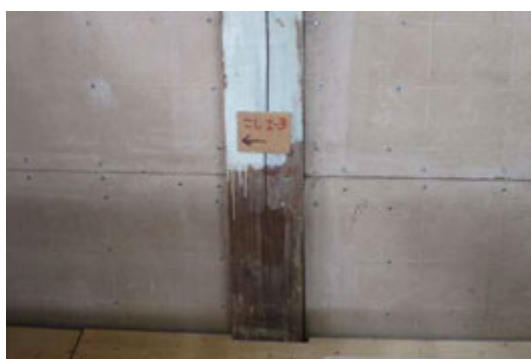
写真 3-9 1階事務室の柱の増設床部分の塗膜
