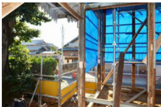
写真 4-16 窓敷居の痕跡
