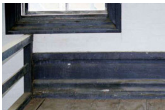
写真 3-6 本館 2 階議場の窓枠と巾木の塗膜
