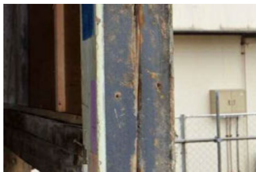
写真 3-5 本館南面の出入口脇柱の塗膜
