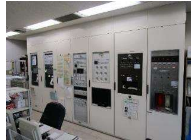
中央監視装置 (地階から本庁舎3階へ)
