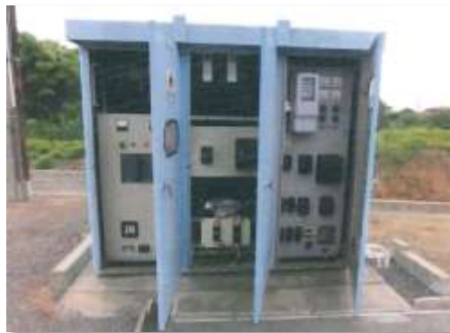
高圧受電設備
