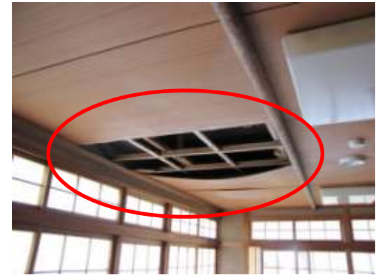
天井部分の 水漏れ損壊
