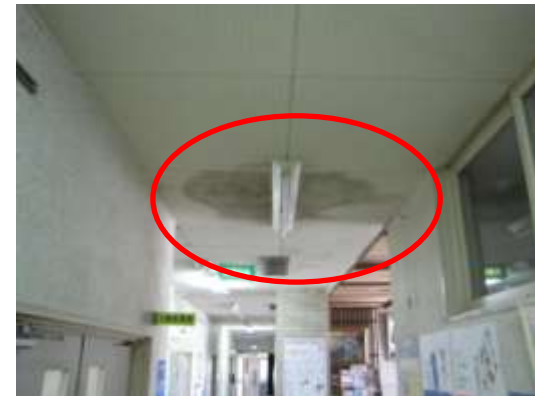
天井部分の 水漏れ
