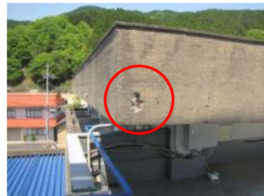
屋根部分の 鉄筋腐食
