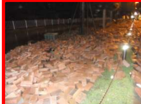
護岸被害 (19:30頃撮影)
