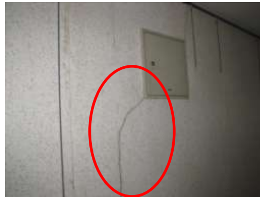
内壁部分の ひび割れ
