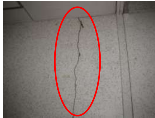
内壁部分の ひび割れ
