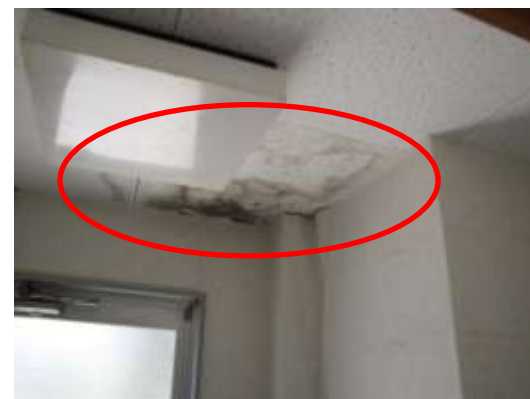
天井部分の 水漏れ
