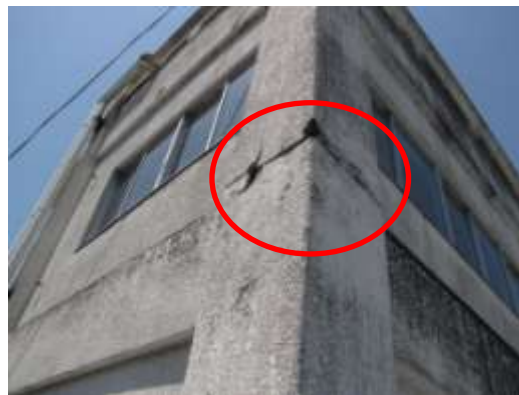
外壁柱部分の 鉄筋腐食
