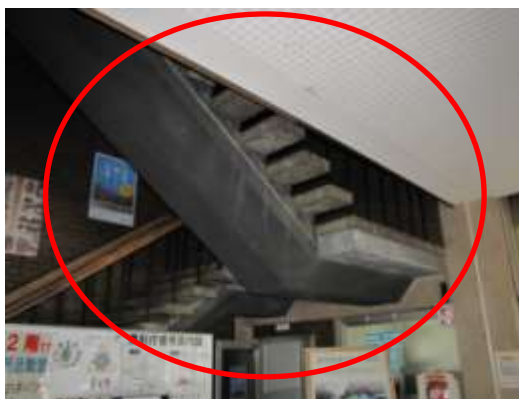
建物内階段の 老朽化
