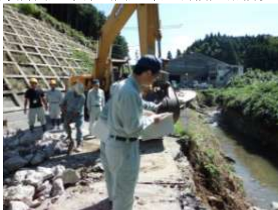
《家所高座原線（高座原川新橋）落橋現場》
