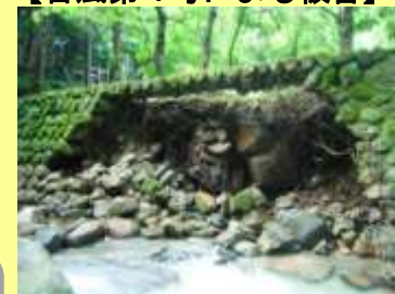
河川の護岸決壊（美杉町八知地内）
