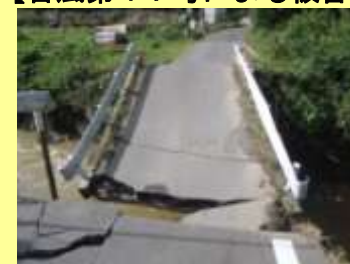
橋りょうの損壊（美里町家所地内）
