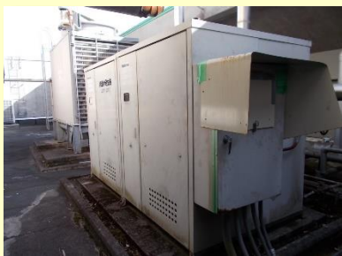
改修が必要な美里文化センター 冷温水発生機
