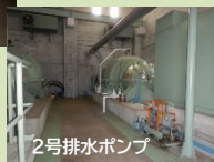
2号排水ポンプ
