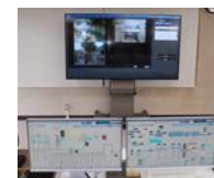
片田浄水場中央監視装置
