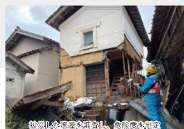
被災した建築物と消防員、危険度判定士
