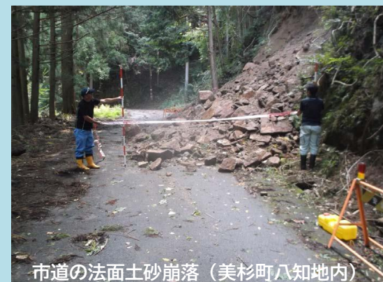
林道の法面・路側崩壊（芸濃町河内地内）
