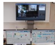
片田浄水場中央監視装置
