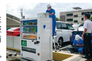
自販機に設置された浸水センサ
