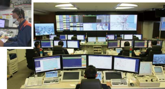
高機能消防指令センター
