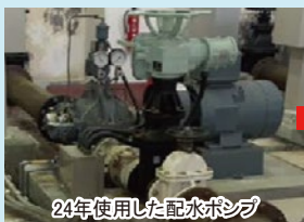
24年使用した配水ポンプ
