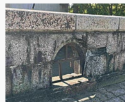
塔世橋に残る爆撃の跡
