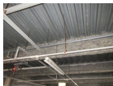
ポルタひさい駐車場 照明器具
