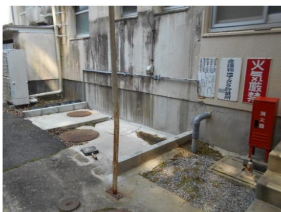
浴場用地下タンク
