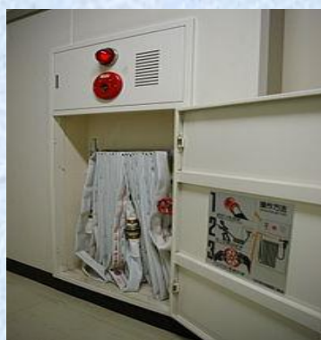
(屋内消火栓設備)
