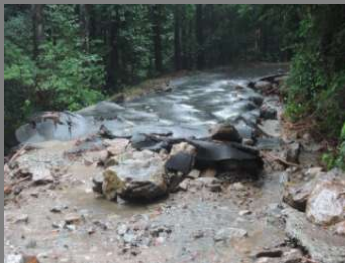
路面・路肩崩壊
