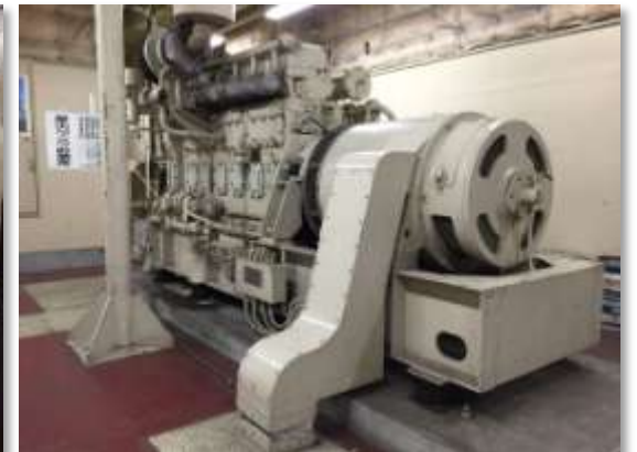
非常用自家発電機設備
