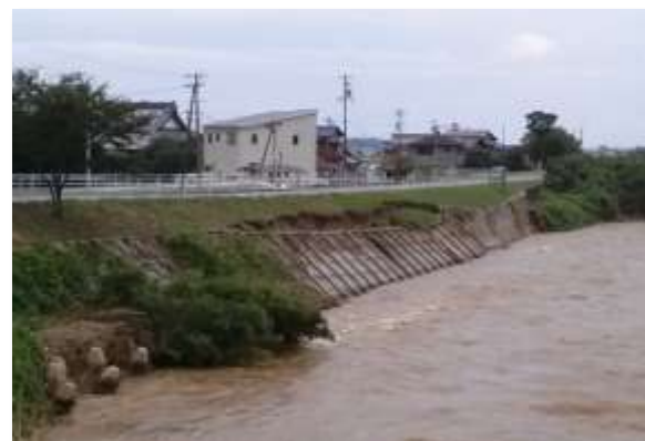
安濃川の護岸崩壊 (安濃町荒木地内)
