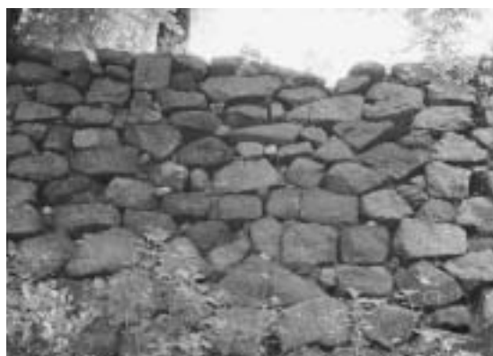
8 本丸北辺石垣の陥没(南から)
