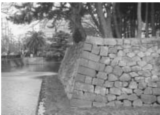
2 玉櫓石垣の孕み(南から)
