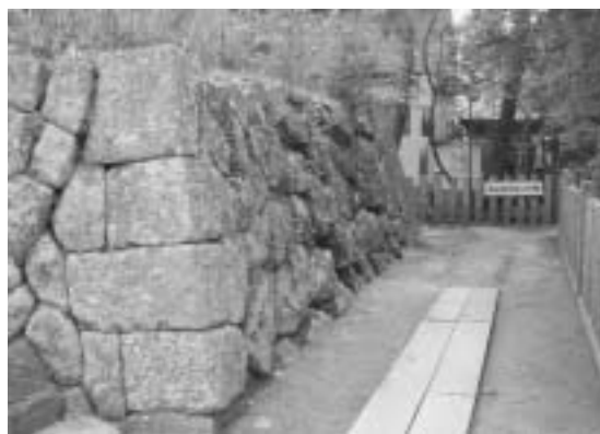
14 本丸西辺石垣の孕み（北から）
