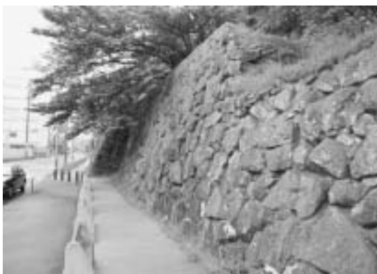
10 本丸東辺石垣の孕み（北東から）
