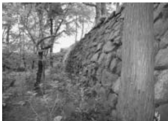
7 本丸北辺石垣の孕み(東から)
