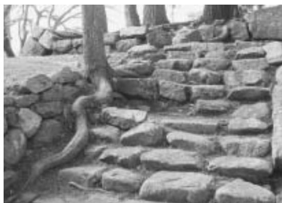
16 西之丸階段の根による崩れ（東から）
