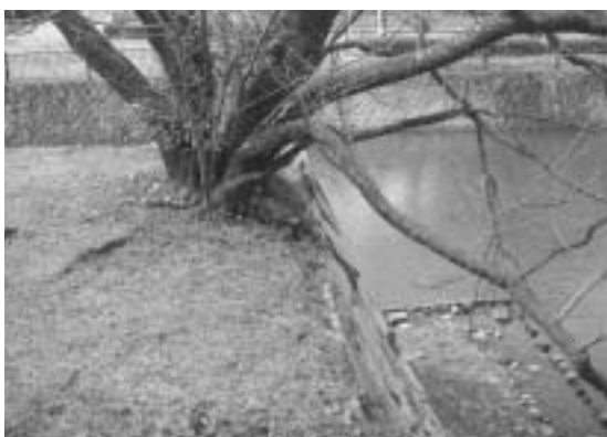
4 西之丸北西角石垣の根による孕み(東から)
