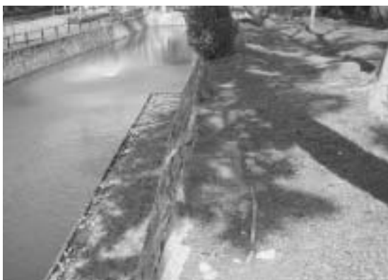
3 西之丸西辺石垣の孕み(南から)
