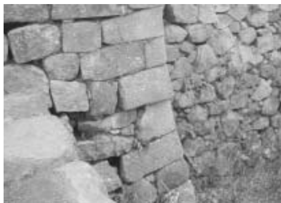
6 本丸戌亥櫓内側角石垣の崩れ(南西から)
