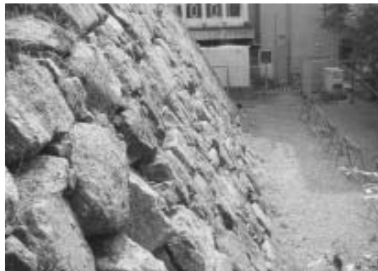
13 天守台西辺石垣の孕み（北から）
