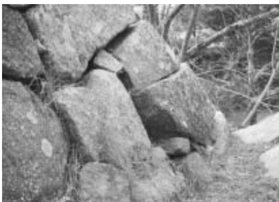
11 天守台北西角石垣のずれ（東から）
