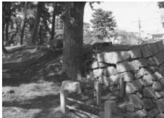
5 西之丸北東角石垣の緩み(東から)
