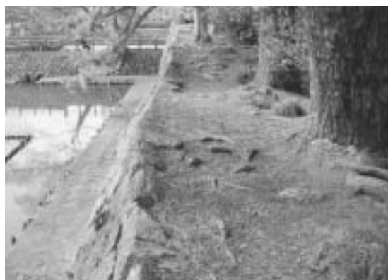
15 後補西辺石垣の孕み（南から）
