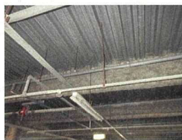
ポルタひさい駐車場 照明器具
