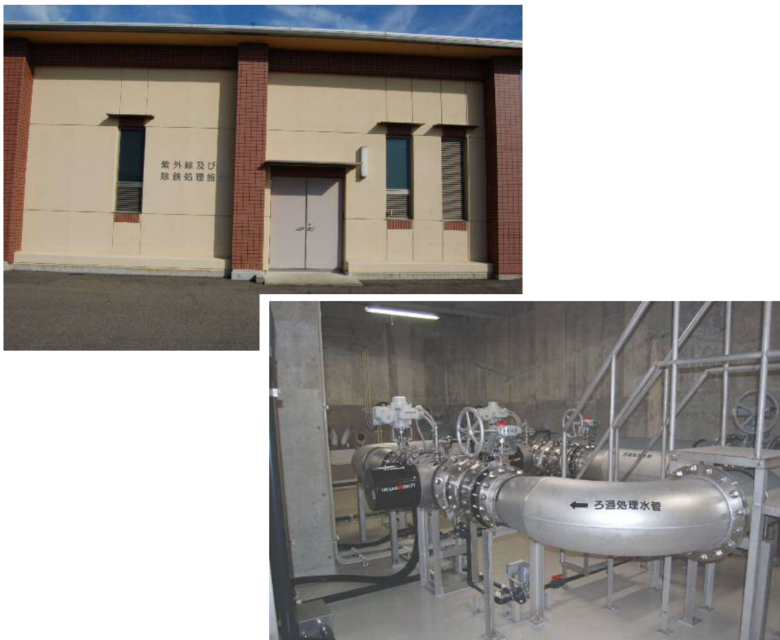
図 5.8 紫外線処理設備（高茶屋浄水場）
