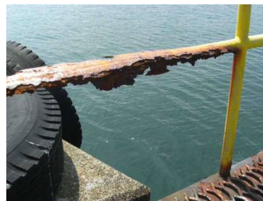
手摺腐食状況
