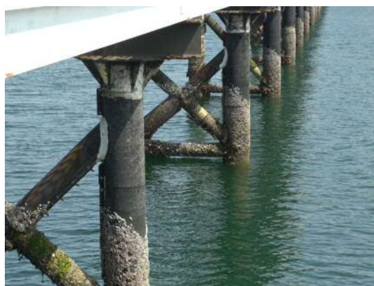
鋼管杭腐食状況
