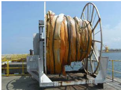
オイルフェンス巻取機
