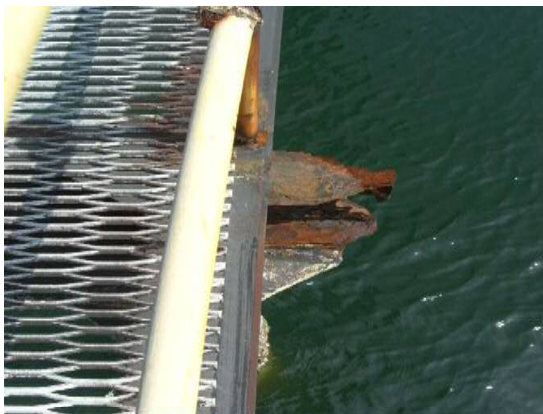
栈橋架台腐食状況
