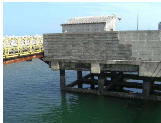
ステージ台座クラック状況
