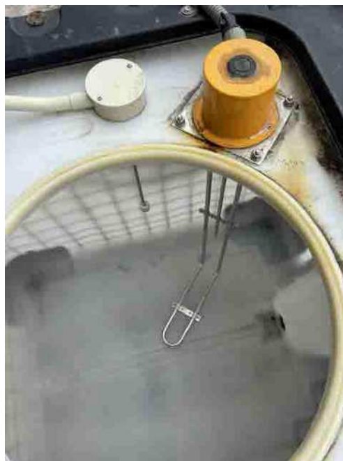
ヒーター（槽内部）
