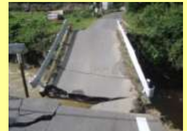
橋りょうの損壊（美里町家所地内）
