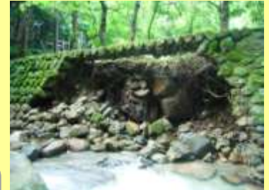
河川の護岸決壊（美杉町八知地内）
