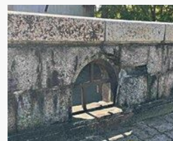
塔世橋に残る爆撃の跡
