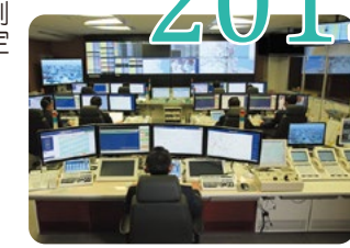
高機能消防指令センター
