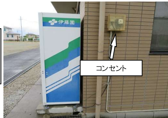
②使用できる設備
