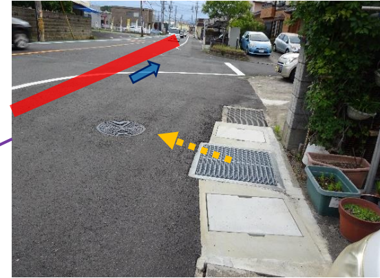
歩道(店舗前)の取水口
