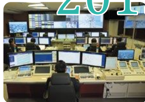
高機能消防指令センター
