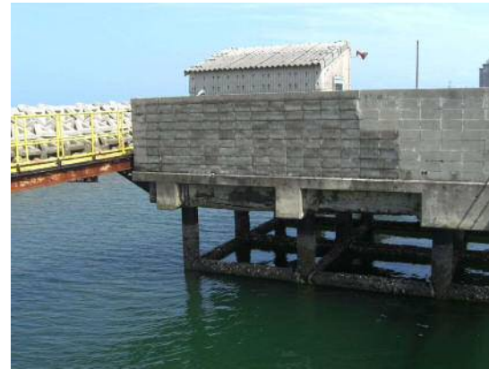
ステージ台座クラック状況
