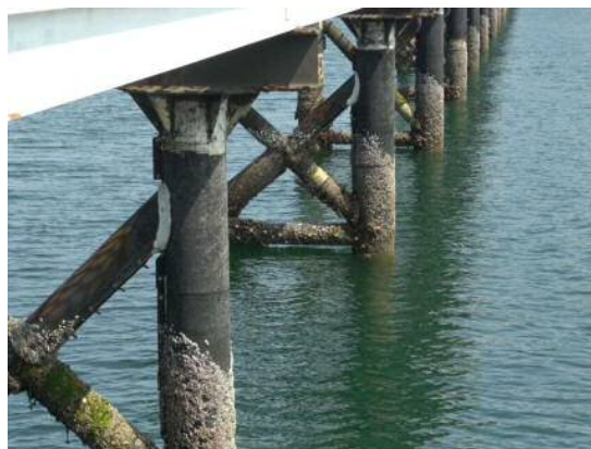
鋼管杭腐食状況
