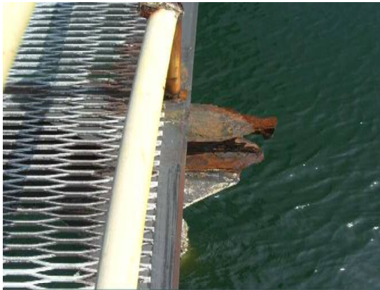
棧橋架台腐食状況
