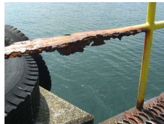
手摺腐食状況
