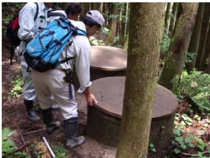
写真 3.2-1 対象事業実施区域付近の沢に設置されている取水設備
