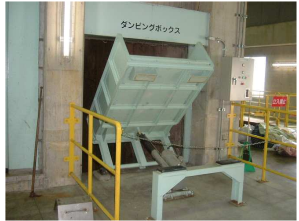
図 - 6 受入施設(ダンピング検査設備)
