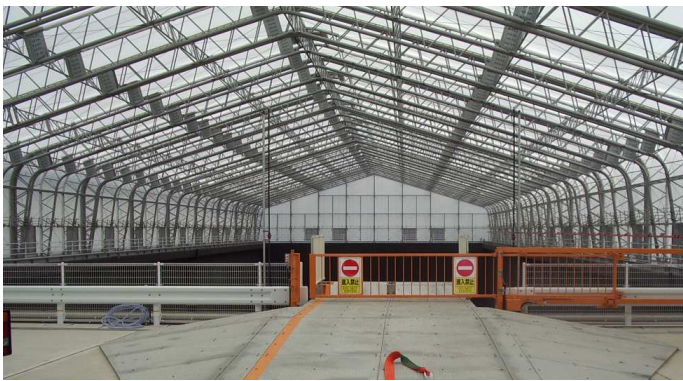
図 - 9 被覆設備(アルミ骨組(パイラチス)+膜構造)
