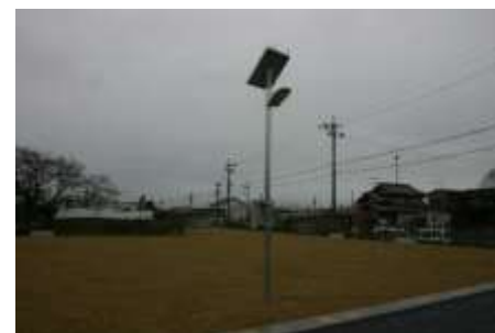
ソーラーLED照明
