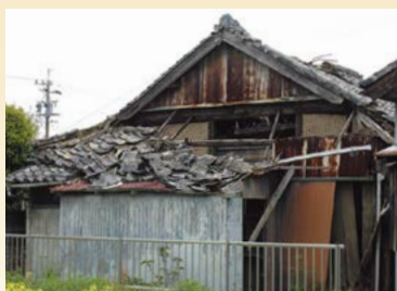
▶ 危険な空き家
