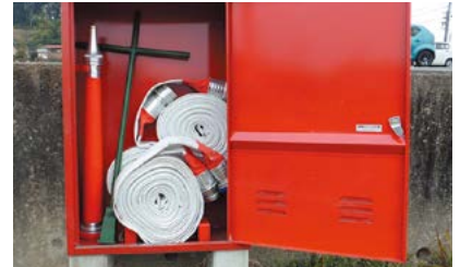
消火栓ボックス内
